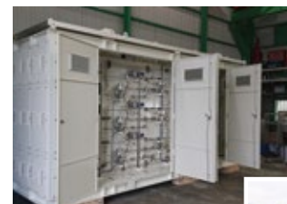
蓄圧器ユニット
